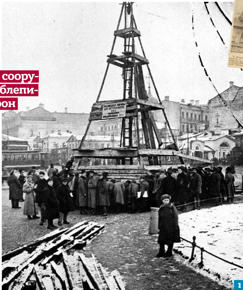
Вышка с табличкой «Разведку почвы для метрополитена МКХ производит Водоканал». 1924–1925 год (1) Газетная вырезка с фотографией вышки (2)
