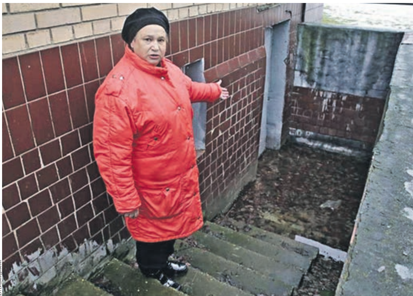
14 декабря 2017 года 13:23 Жительница Остафьева Людмила Дворникова у входа в подвал жилого дома, который еще с лета залит водой. Из-за этого в подвезде — настоящая баня, изрядно сдобренная невыносимыми запахами
