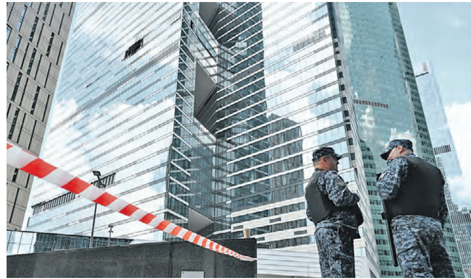
1 августа 2023 года. Последствия удара украинского беспилотника по комплексу «Москва-Сити»: поврежден фасад здания на уровне 21-го этажа
