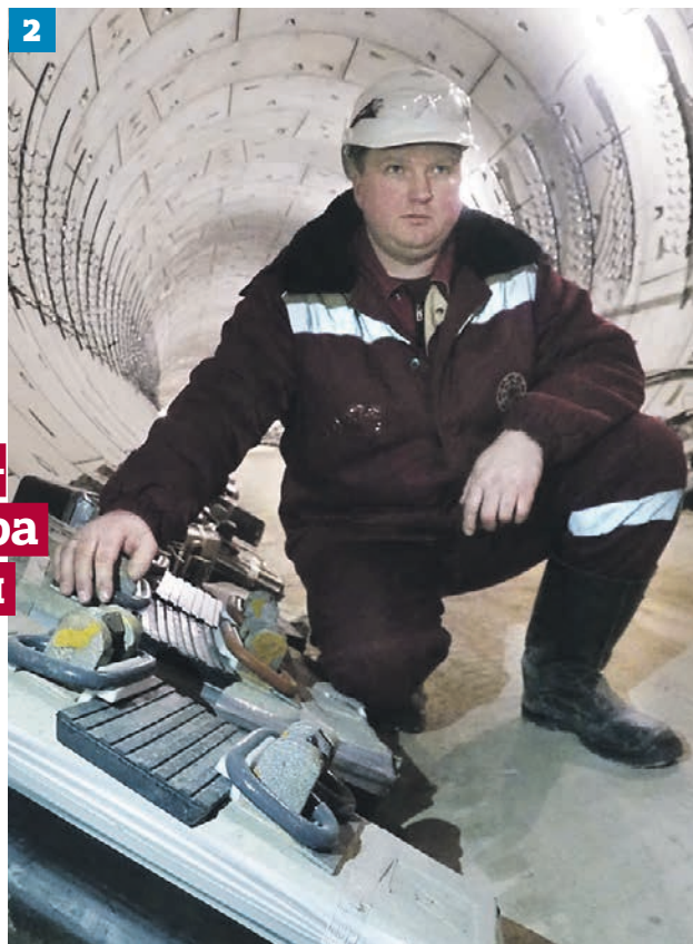
Проект вестибюля станции «Лефортово» (1) 5 февраля 2019 года. Замначальника участка «Тоннель-2001» Вадим Мурашко проводит осмотр хода работ на северо-восточном участке Большого кольца метро (2)
