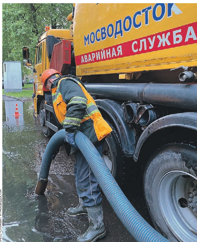
29 мая 10:43 Дежурная бригада Мосводосток устраняет подтопление на улице Серпуховский Вал
