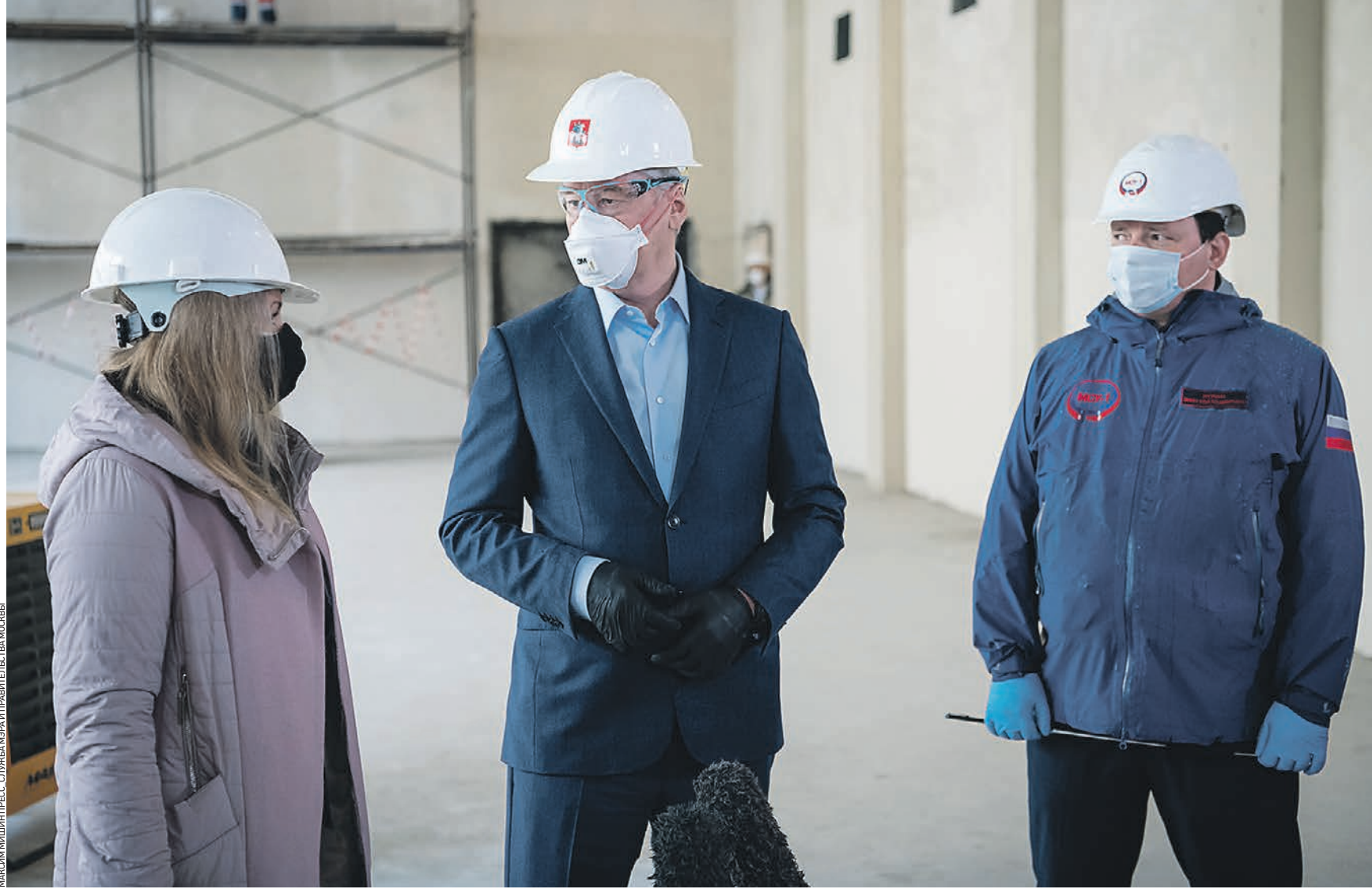
Вчера 14:09 На фото (слева направо): исполняющая обязанности директора «Школы Новоосино» Оксана Варченко, мэр Москвы Сергей Собянин и президент компании, выполняющей строительные работы, Илья Зюбин во время посещения нового корпуса образовательного учреждения
