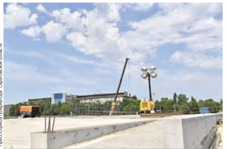
Реконструкция Трофимовского моста осложнила транспортную ситуацию в городе, но ремонт объекта откладывать было нельзя.
