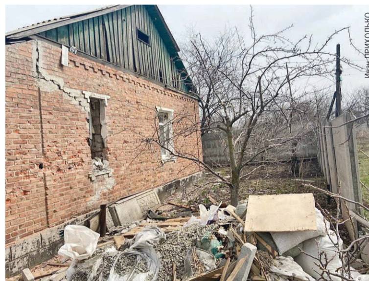
Таких разрушенных домов в ДНР очень много.
