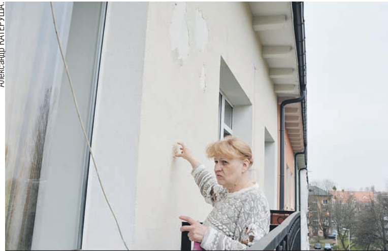
У Людмилы Ивановны краска облупилась прямо на стене балкона.
