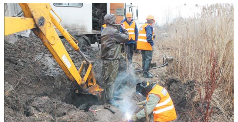
Более 17 миллионов рублей выделили для замены 1,5 тыс. метров водовода в Шахтах. Фото из архива редакции.
