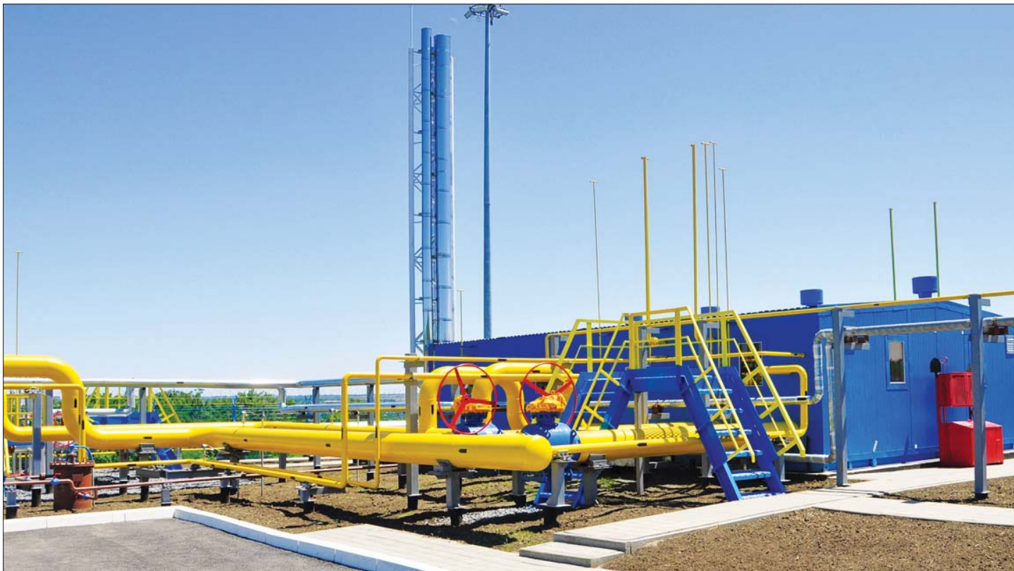
В результате реконструкции проектная производительность ГРС «Шахты-2» увеличена более чем в семь раз — до 151,7 тыс. куб. м в час. Фото с сайта www.gazprom.ru
