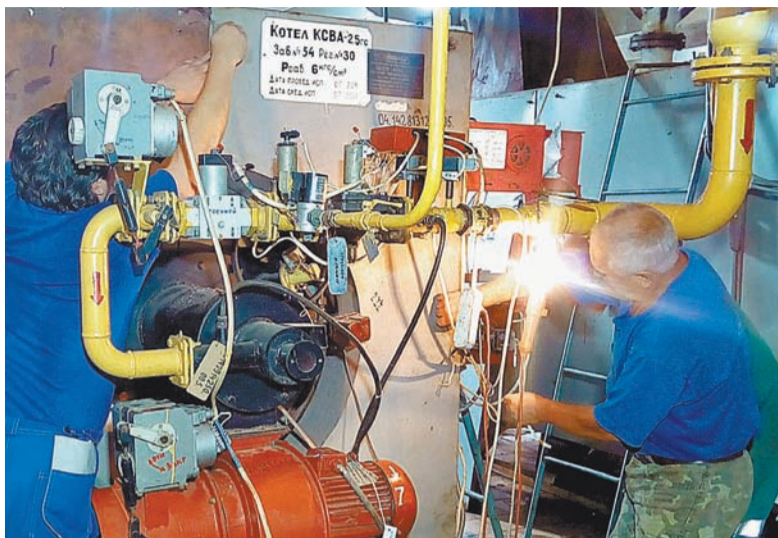
Когда приходит инвестор, обновляются сети и объекты ЖКХ.
